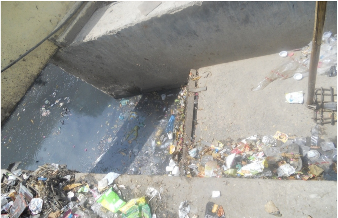
Fig 5.24: Budi ka Nagla STP inlet.
